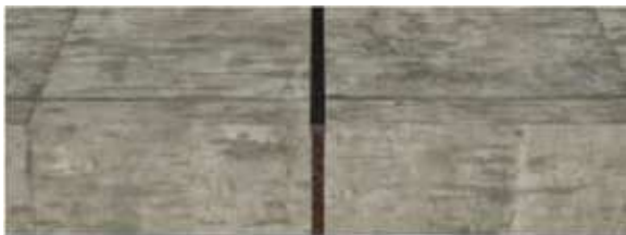
Junta de dilatação contínua
